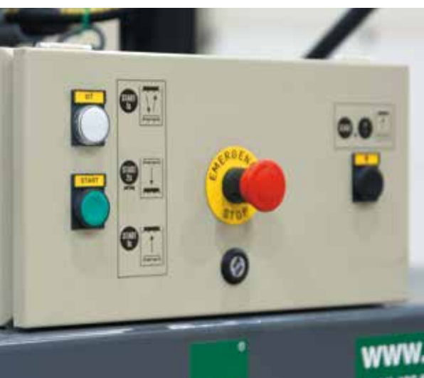
Všechny rozvaděče jsou vybaveny nejmodernějšími elektrotechnickými komponenty včetně centrálního bezpečnostního modulu
